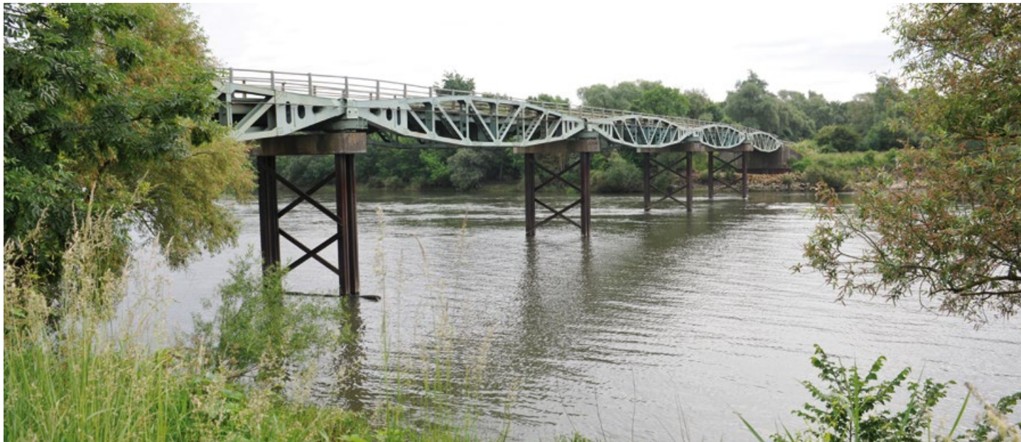
Ci-dessus : le pont de franchissement de la Moselle entre Cattenom et Koenigsmacker (sur la RD56) sera transformé en ouvrage à deux voies.
